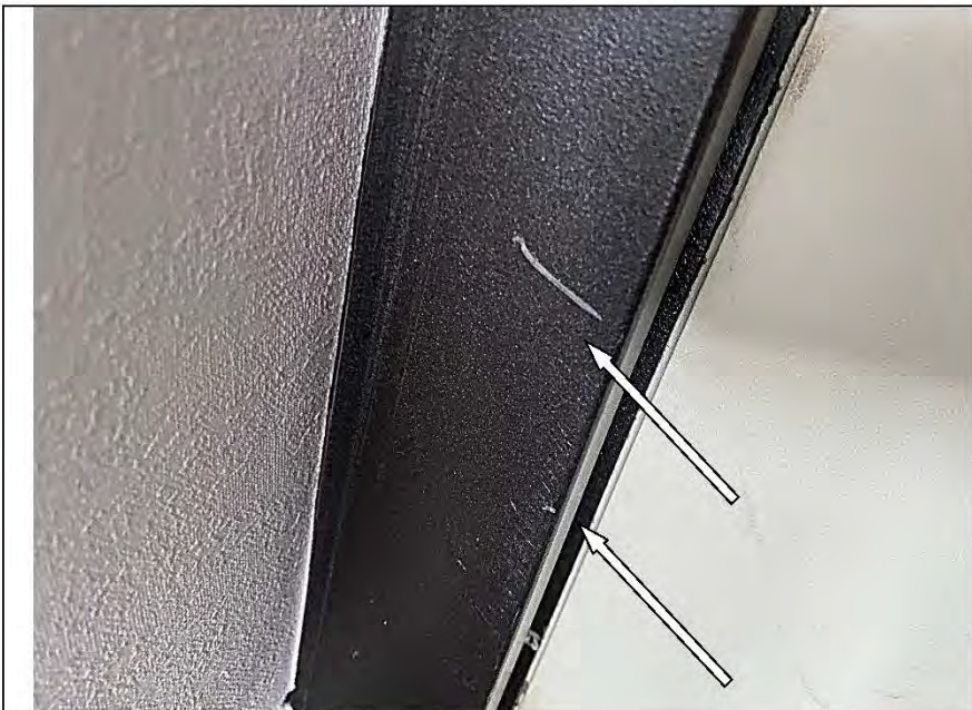
Фото №16. Коробка входной металлической двери имеет дефекты.
