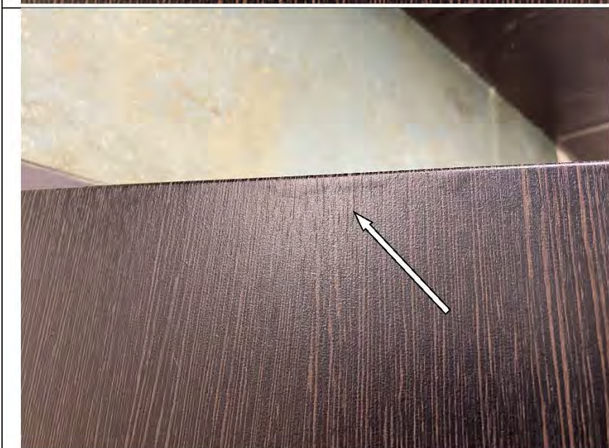
Фото №18. Полотно входной металлической двери имеет дефекты.
