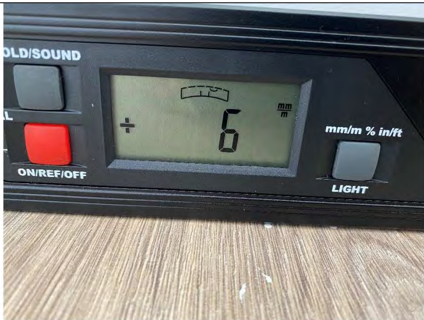
Фото №13. Измерение уровня напольного покрытия в спальне.
