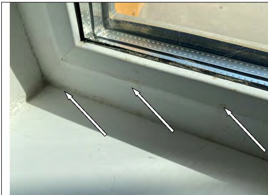
Фото №31. Профиль ПВХ оконного блока в кухне имеет дефекты.
