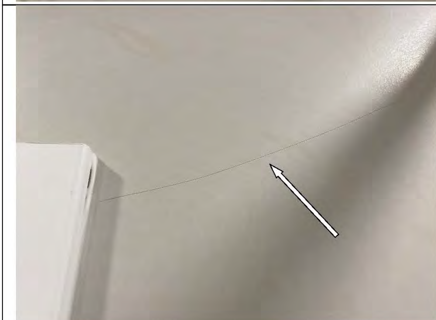
Фото №27. Трещины, отбитости настенной керамической плитки в ванной комнате.
