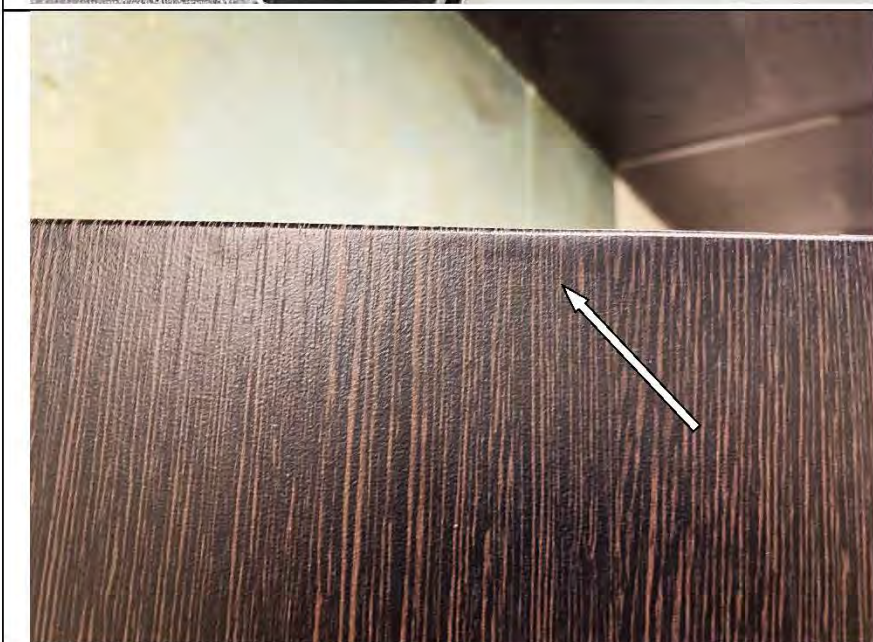
Фото №17. Полотно входной металлической двери имеет дефекты.
