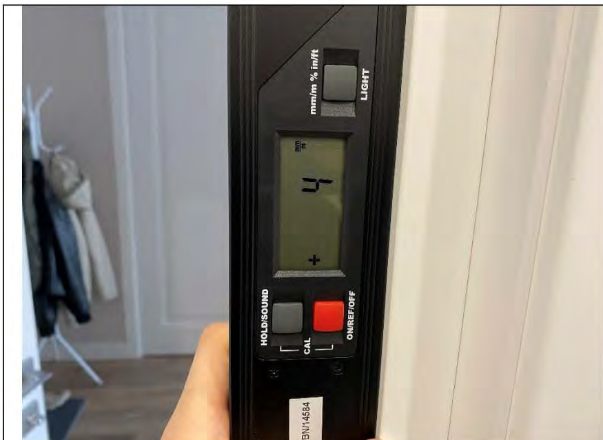
Фото №19. Отклонение коробки дверного блока от плоскостности и прямолинейности в ванной комнате.
