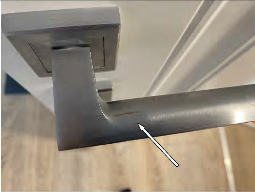
Фото №22. Царапины на фурнитуре деревянного дверного блока в кладовой.
