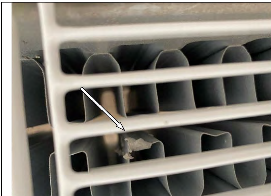
Фото №37. Радиатор в спальне имеет дефекты.
